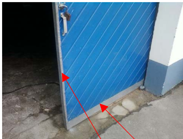
eine nachgearbeitete Tür - seitlicher und unterer Kantenschutz
